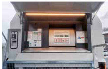
Die umgerüstete Kehrichtentsorgungsanlage in Lungern.
