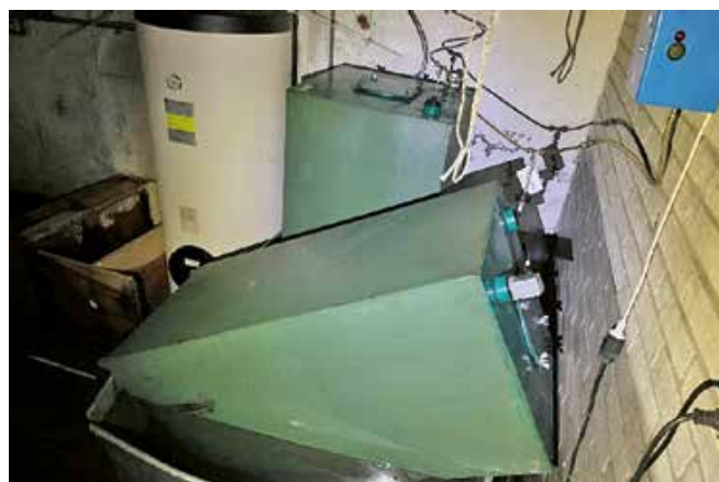
Wassereintrich Keller Heizöltank gekippt.
